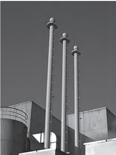
Bild 70. Abluftkamine mit Schwingungsdämpfer
